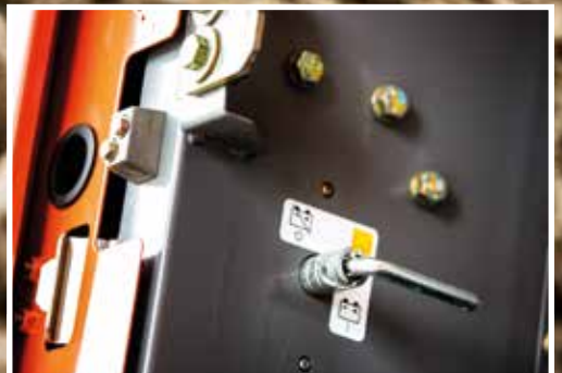
Erotuskatkaisin on parantanut turvallisuutta huoltöissä.
